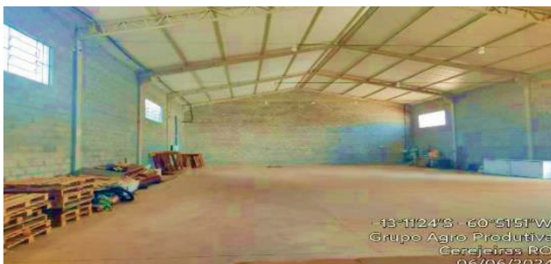
DEPÓSITO COM PLACAS SOLARES - FILIAL DE CEREJEIRAS - RO
